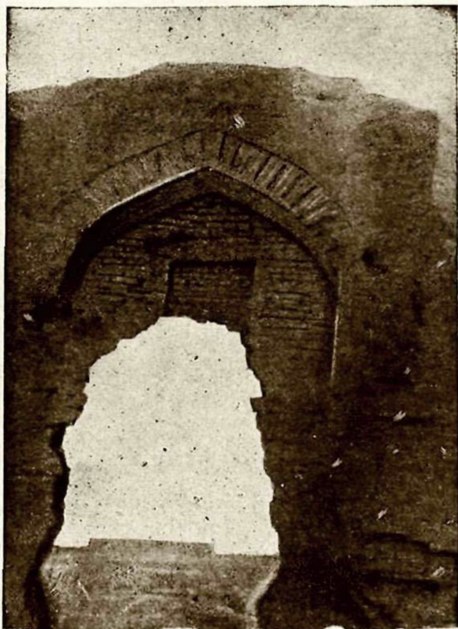
Рис. 18. Пролом в стене здания № 12.
