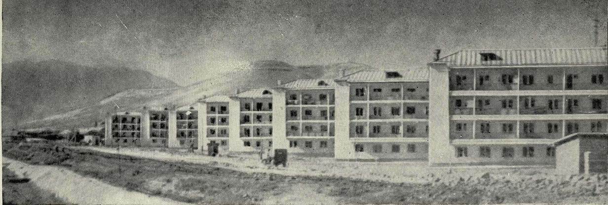
Строительство жилых галерейных домов на Самаркандской трассе в Сталинабаде. Архитекторы В. Афанасьев, В. Захаров, Г. Полтораки. Панорама застройки, фасад жилого дома
