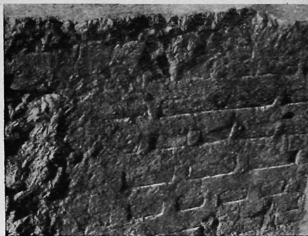
Рис. 19. Тип кладки «кирпич вразбежку»
