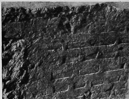
Рис. 19. Тип кладки «кирпич вразбежку»
